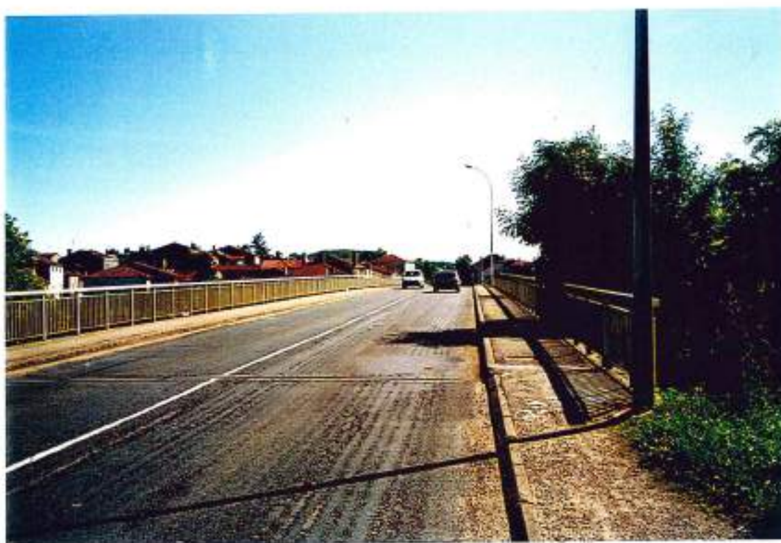
47-18 (n°4-12A)- D217 Pont de Casseneuil : à sécuriser
