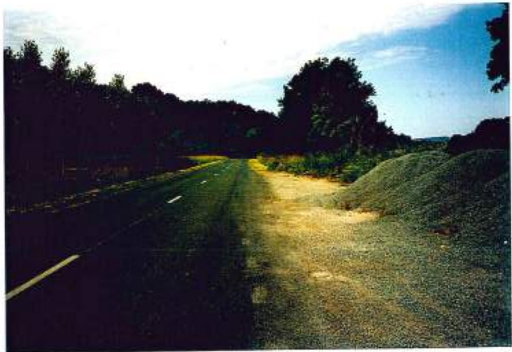
47-40 (n°5-16)- RD 243, à la sortie de Penne-d'Agenais, vers Fumel: à sécuriser sur 1,2 km
