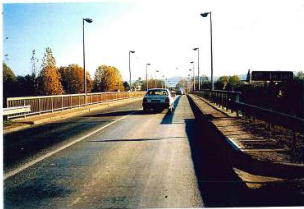
47-15 (n°2-20A)- Pont de Ste-Livrade-sur-Lot (D667): à sécuriser
