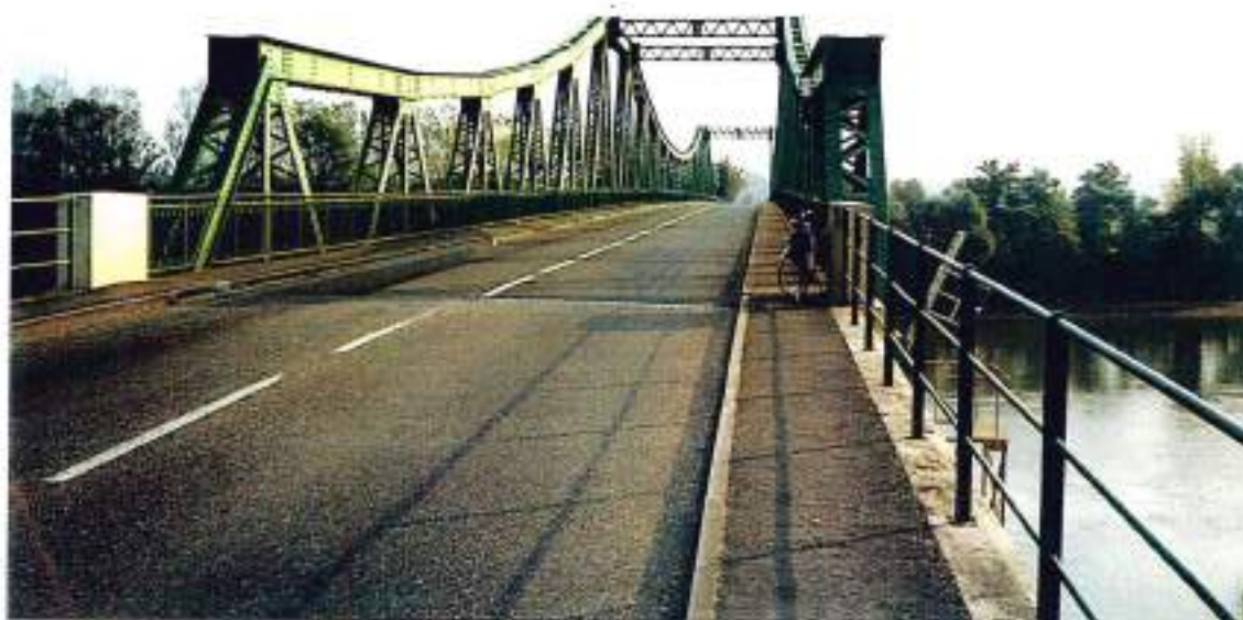
47-2 (N°1-19A)- D8 au pont de St-Léger : danger car pont étroit (voies de 3m) et très circulé (4000 véh/j, 16% de PL). Passerelle à créer.
