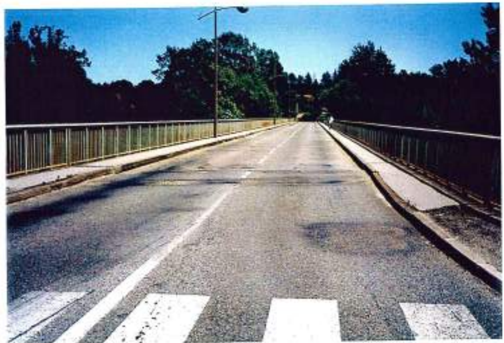
46-22 (n°10-6A)- Le deuxième pont de Luzech (D8 direction Douelle): à sécuriser
