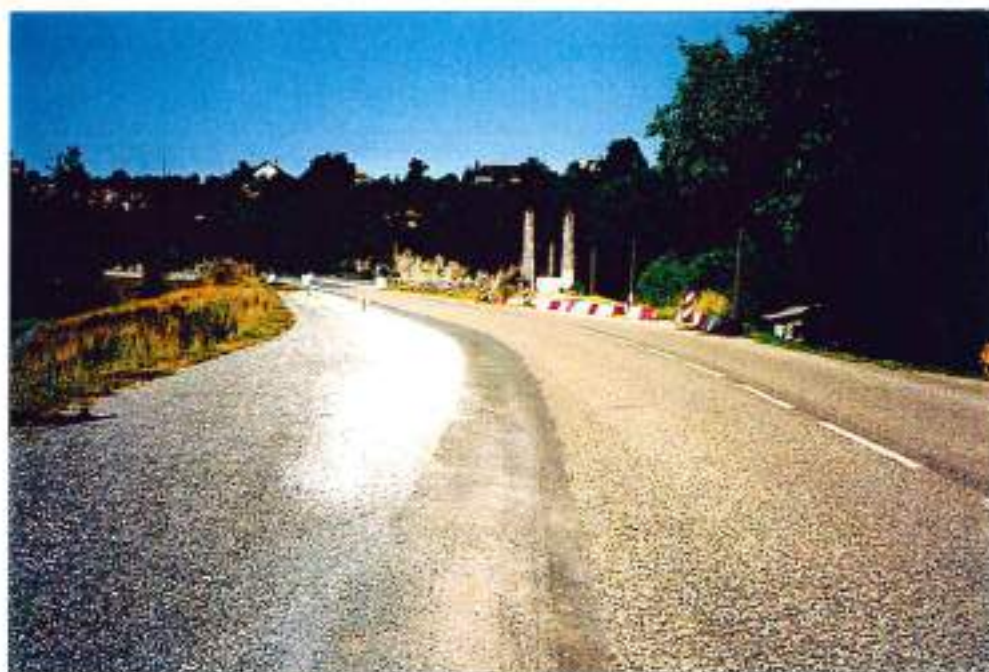
46-78 (n° 16-5A)- La D19 à Andressac : à sécuriser (0,3 km)
