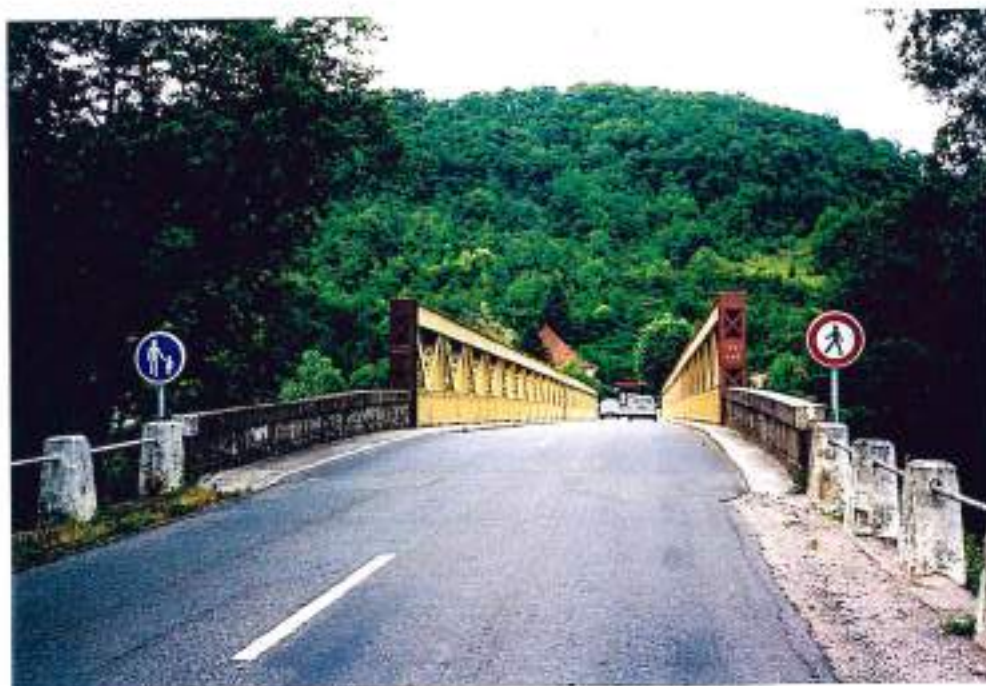
46-85 (n°17-34A)- D922 - Le pont de La Madeleine : trafic élevé, ligne médiane pointillée, pas de limitation de vitesse, pas d'aménagement. A sécuriser.
