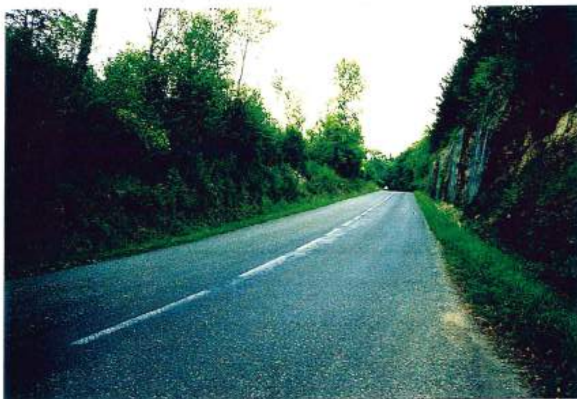
46-75 (n°15ter-16A)- Vallée du Célé- D19 avant Figeac : chaussée de 6 m, à sécuriser par marquage de files et sur-largeurs voir aussi plus loin la photo n°46-87- D662 dans Figeac av G. Pompidou
