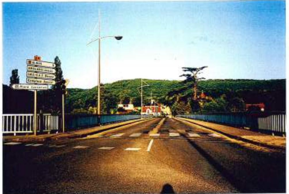
46-21 (n°9-7A)- Le premier pont de Luzech (D8 direction Albas): à sécuriser
