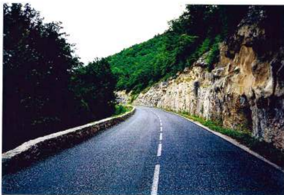
46-30 (n°11-28A)- La D8 1 km après Douelle vers Cahors (tronçon A): 1,6 km à sécuriser par ré-ouverture du chemin de halage envahi par la végétation (visible à gauche sur la photo)
