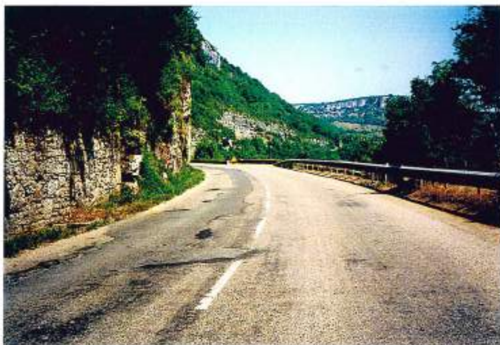
46-79 (n° 16-19A)- La D662 avant Cajarc : descente de 1,3 km, 1200 véh/j, chaussée de 7,20m. A sécuriser
