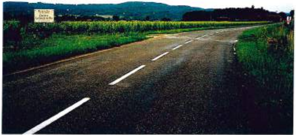
46-3 (n°7-29)- La D8 à Vire-sur-Lot : à sécuriser sur 2 km
