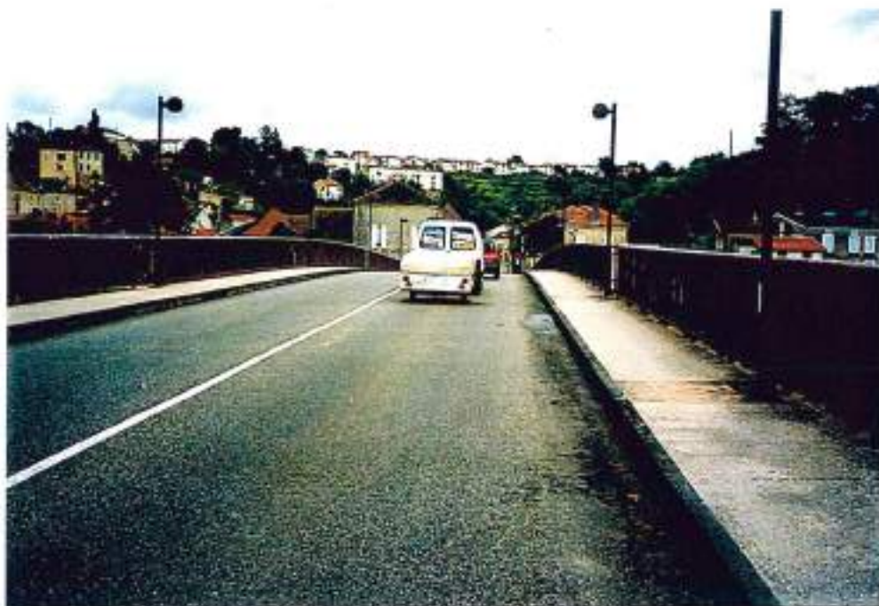
46-5 (n°7-2°-7)- Pont de Puy l'Evêque : à sécuriser par marquage de files et sur-largeurs
