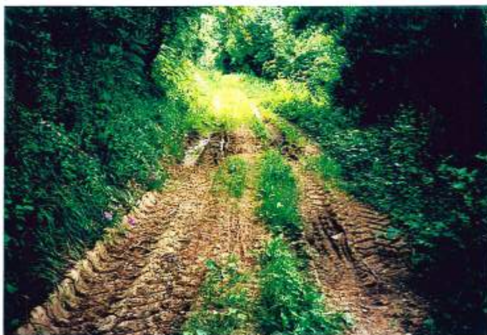
46-83 (n°17-9A)- Après Frontenac, chemin au bord du Lot entre passage à niveau "Le Bac" (aire de loisirs) et Gaillot: 500m dégradé, revêtement à améliorer
