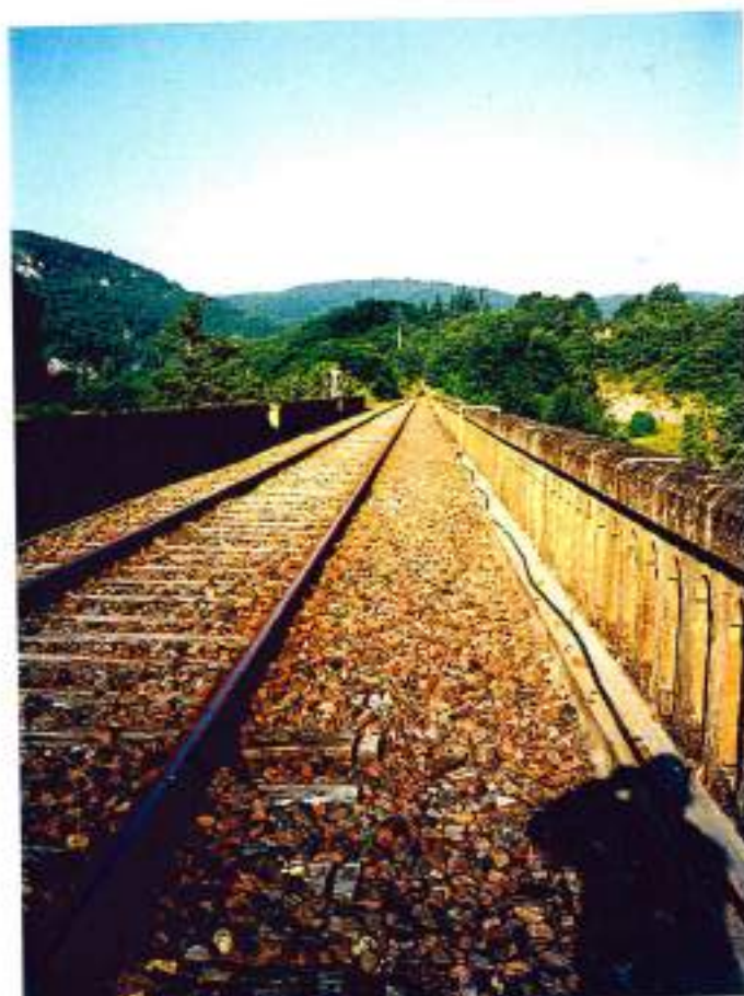
46-66 (n°15-14A)- Le pont de la voie ferrée à St-Géry/Les Masseries : 1,70m disponible côté amont, pour créer un sentier de 0,70m de large
