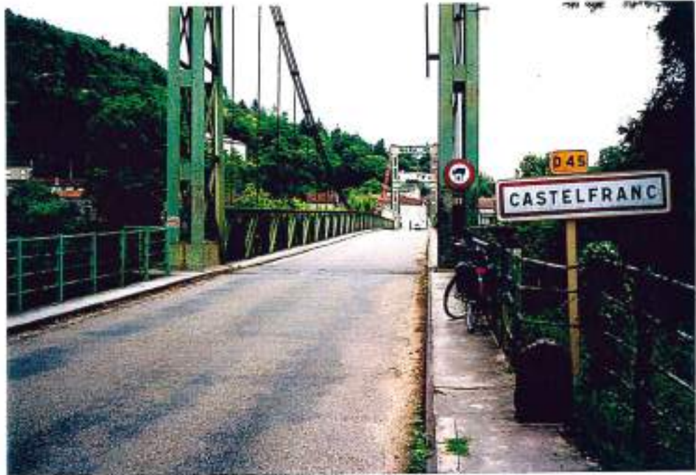
46-9 (n°8-7)- Pont de Castelfranc : à sécuriser par marquage de files
