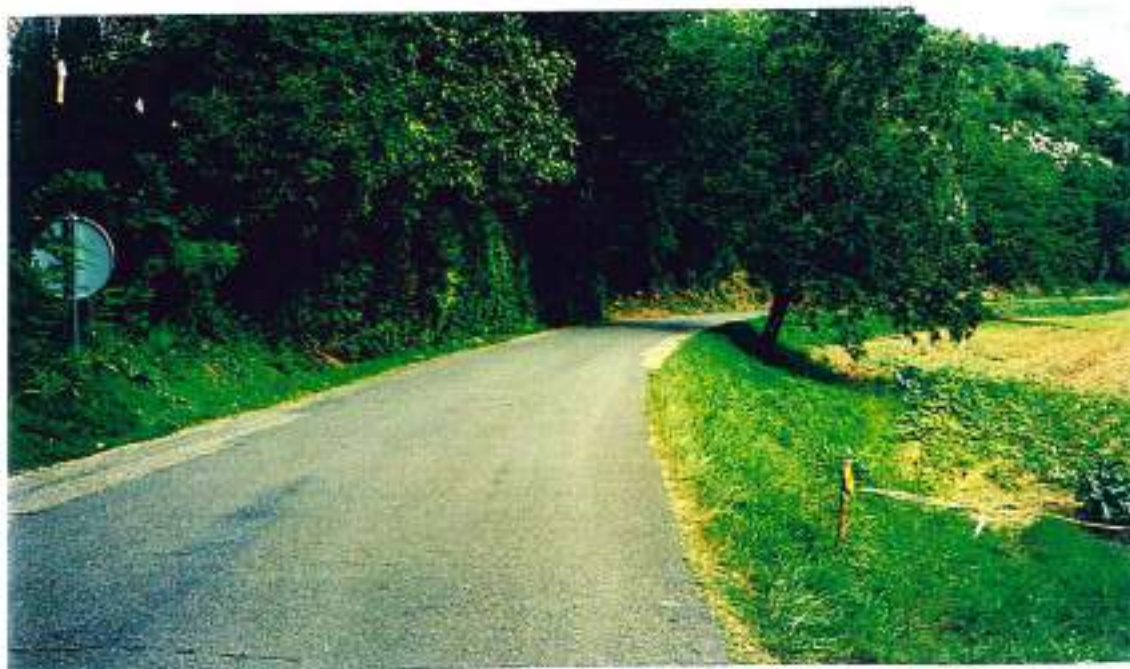
46-72 (n°15ter-12A)- Vallée du Célé- La D41 après le tunnel de La Pescalerie : chaussée très étroite (4,60 m). A sécuriser.
