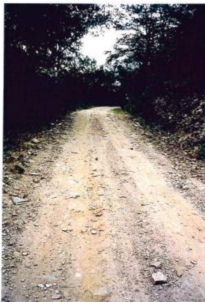
12-37 (n°24-20) - Itinéraire "futur": tour du lac de Lous rive gauche : sentier empierré, ici dégradé par le ravinement et les autos dans la première montée à 1 km du barrage
