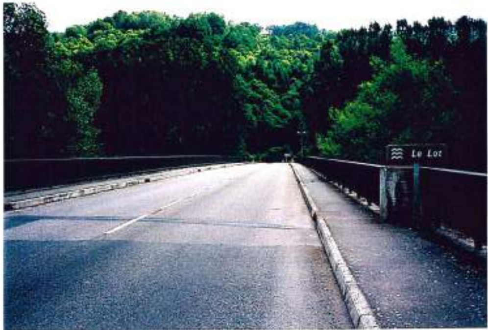
12-15 (n°19-11)- Le pont de la D21 à Livinhac-le-Haut : à sécuriser par des bandes cyclables (chaussée de 7,60m)
