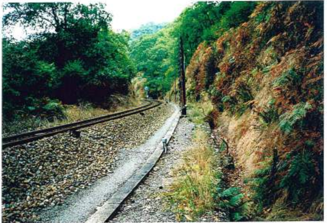
12-7 (n°20bis-5)- La voie ferrée Capdenac-Decazeville après Assier : zone au pied des rochers avec rideau de câbles testeurs d'éboulement
