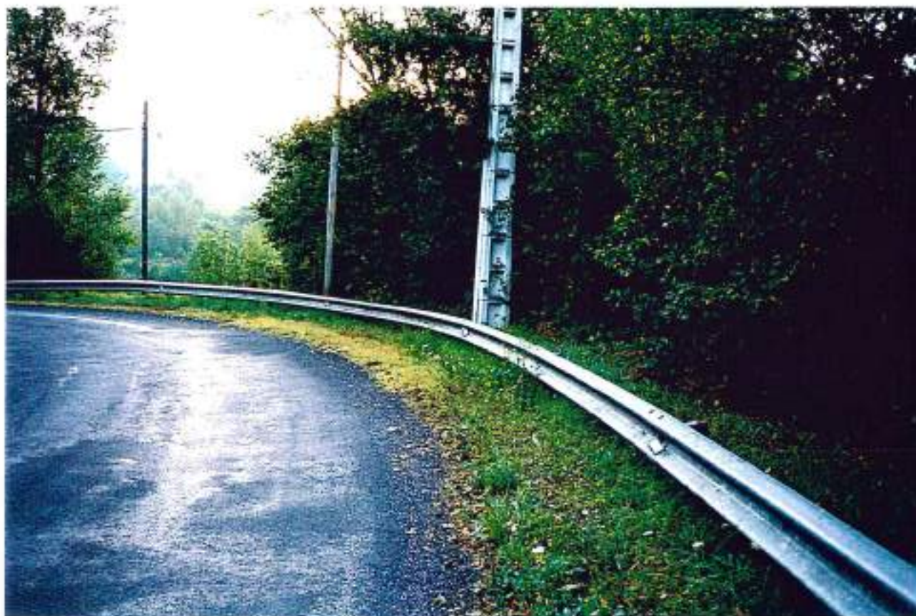
12-26 (n°21-35) - La D107, 1,5 km avant Entraygues: barrières métalliques sur la route touristique de la vallée, face au confluent Lot/Truyère, à remplacer par des barrières en bois
