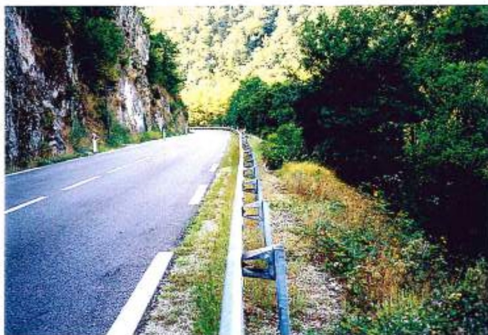
12-31 (n°22-12/12A) - D920 d'Entraygues à Estaing : à 2 km d'Entraygues, après le Relai de la Cambuse, absence de bas-côté, grande ligne droite
