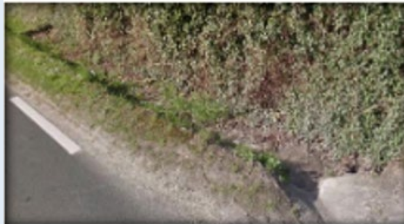
Fossé végétalisé avec limiteurs de débit
